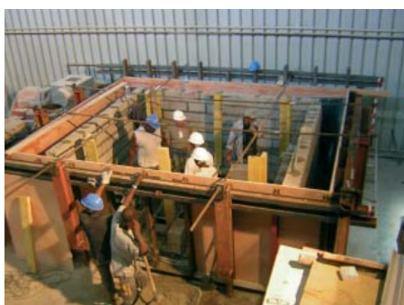
Simulation PPRI (Plan de Prévention des Risques Inondation) 2006 de la RATP. Édification et test de protections maçonnées : mise en eau, mesure des déformations et infiltrations.
